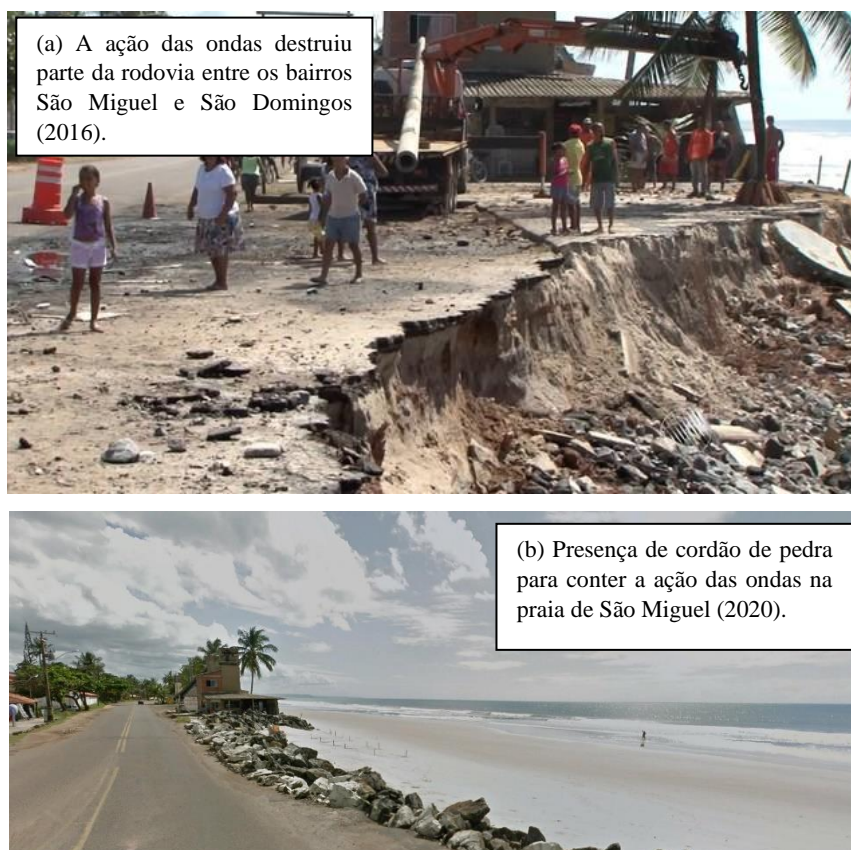
Figura 2 – Processos erosivos nas Praias Do Norte –Ilhéus – Bahia
