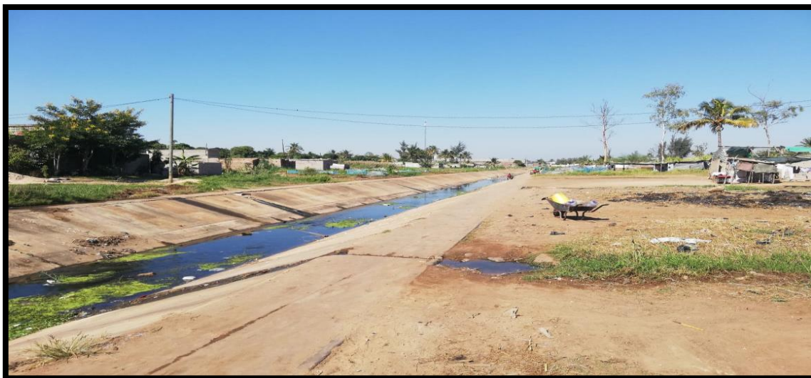
Figura 5. Vala de drenagem contendo resíduos sólidos no Bairro de Machava.
