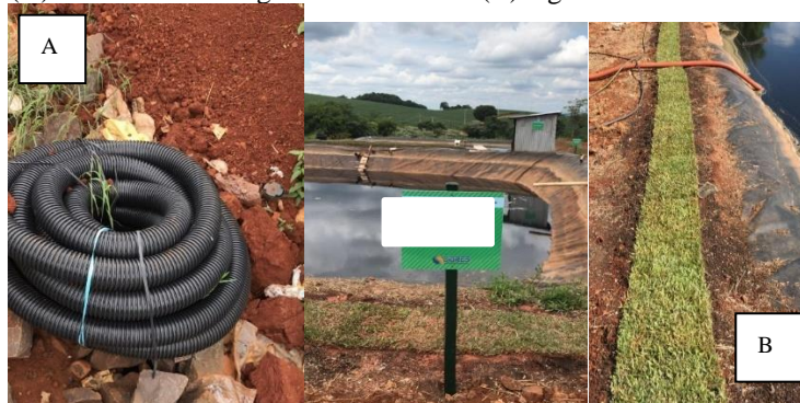
Figura 4 - (A) Sistema de drenagem de lixiviado e (B) lagoas de tratamento dos efluentes.
