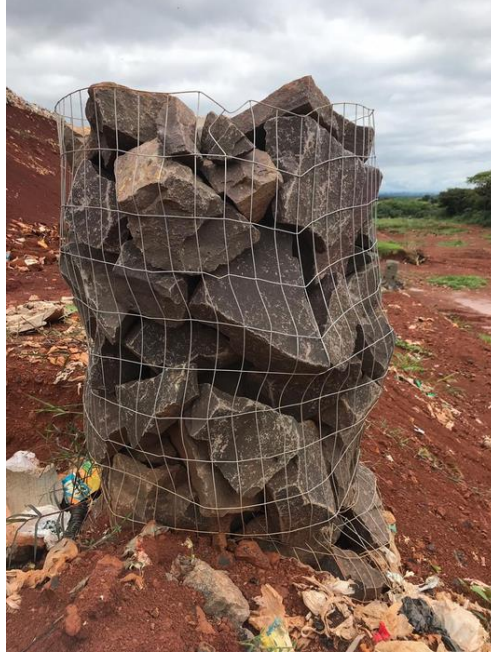
Figura 6 - Drenagem do gás presente na parte interna do aterro.
